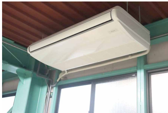
エアコン（第2検品現場）
