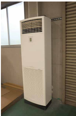
エアコン（第1検品現場）
